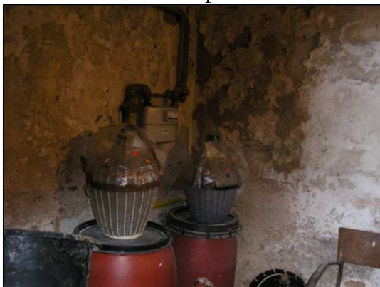
Zavlhání zdiva ve sklepě
