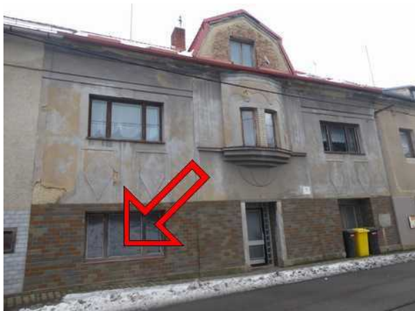
neupravený prostor v domě, úroveň domu pod komunikací
